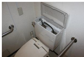
トイレの節水弁
